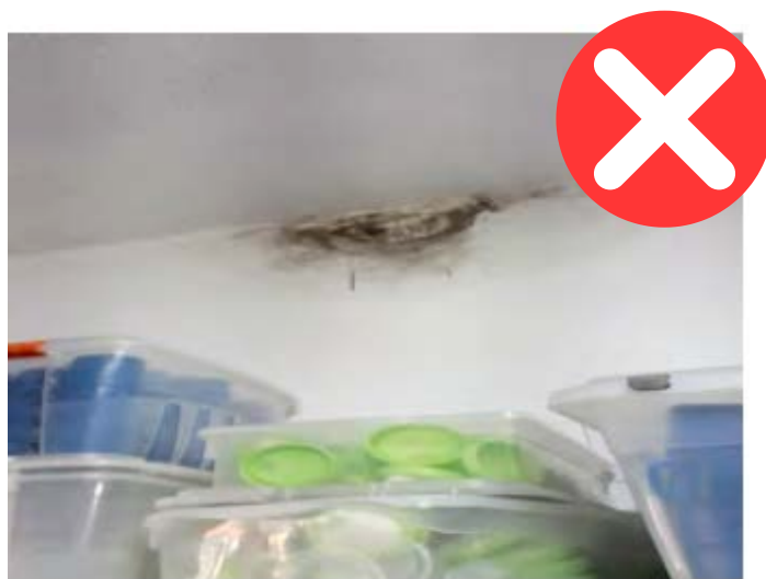
Teto com infiltração
